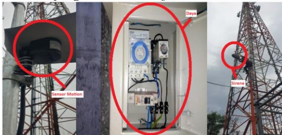
Gambar 1. Sistem Surveillance Yang Sebelumnya Sudah Terpasang
