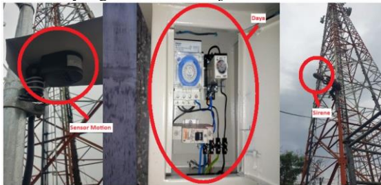
Gambar 1. Sistem Surveillance Yang Sebelumnya Sudah Terpasang
