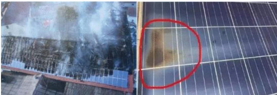
Gambar 1.2 Kebakaran pada panel surya [14]
