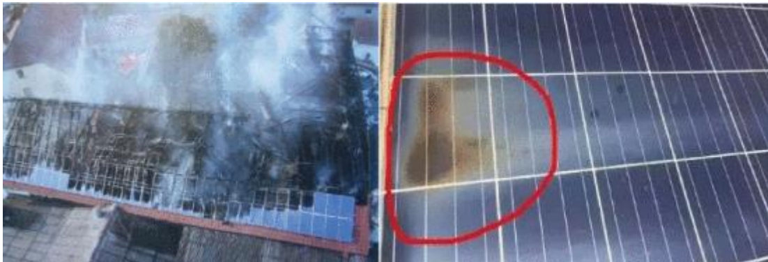
Gambar 1.2 Kebakaran pada panel surya [14]
