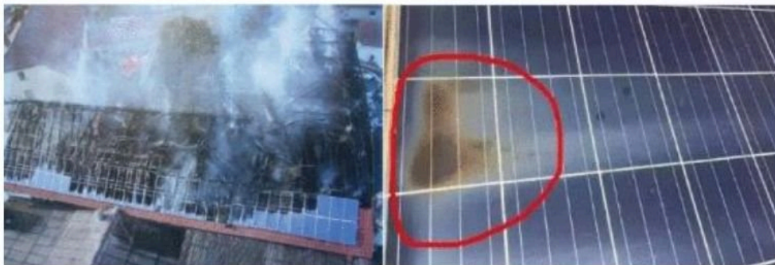
Gambar 1.2 Kebakaran pada panel surya [14]
