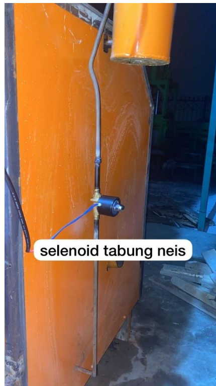
Gambar 1. 3 Selenoid yang menghubungkan tabung tekanan hasil pemanasan air dengan spray ke ruang bakar
