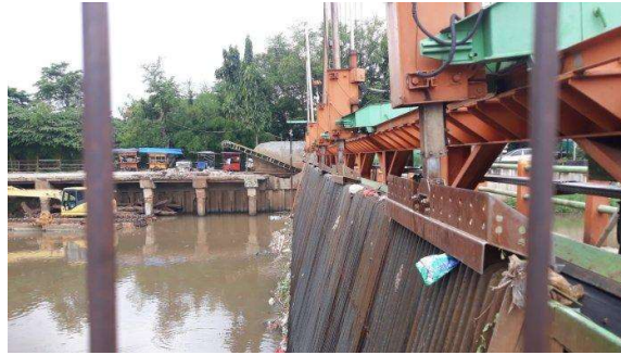
Gambar 1.3 Sistem Penyaringan Sampah di Drainase Cengkareng
