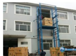
GAMBAR 2 - 1. Contoh lift barang pada bangunan pabrik
