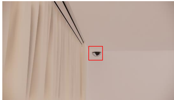
Gambar 12. Penerapan CCTV Sumber: Dokumentasi Pribadi
