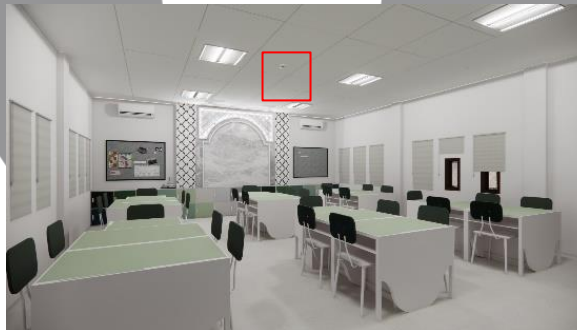
Gambar 11. Smoke Detector pada Ruang Kelas Sumber: Dokumen Pribadi
