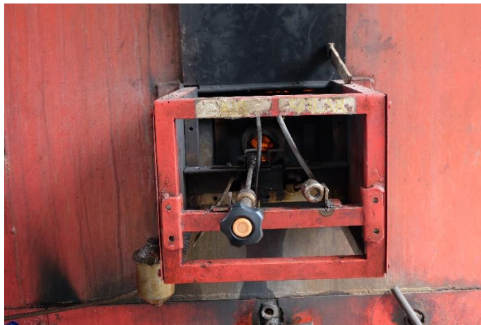
Gambar 1.2 Kenop Input dan Pengaturan Bahan Bakar Rusak
