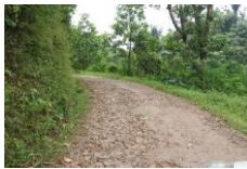
Gambar 2. Kondisi akses jalan
