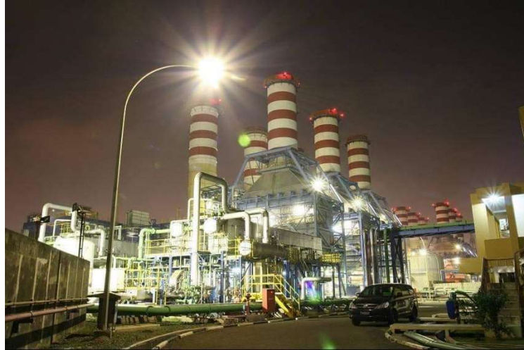
Gambar 1.1 Unit Pembangkit Tenaga Listrik di PT. Indonesia Power Priok POMU
